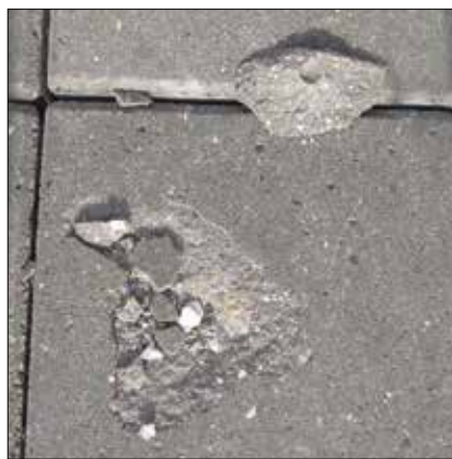
En "kalkspringer", dvs. en vandmættet kalksten har udvidet sig i frostvejr, og presset en flage af betonen.
